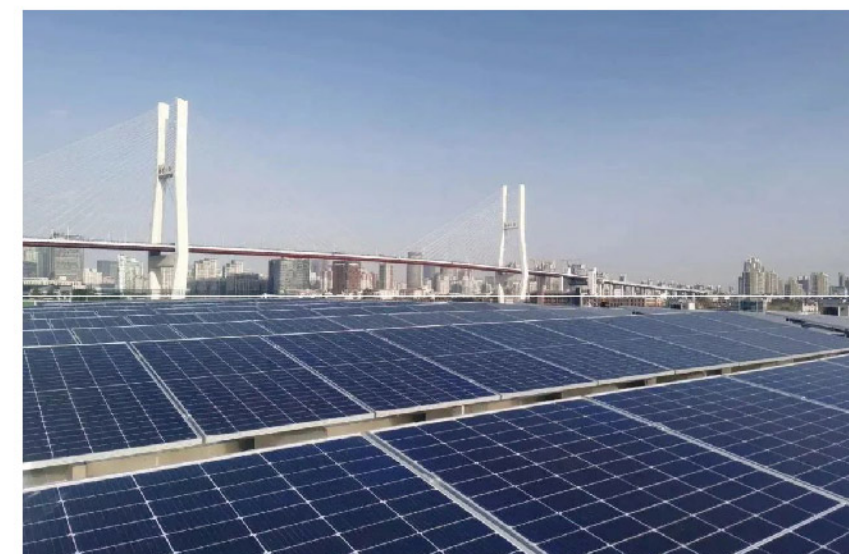
南市水厂光伏项目
